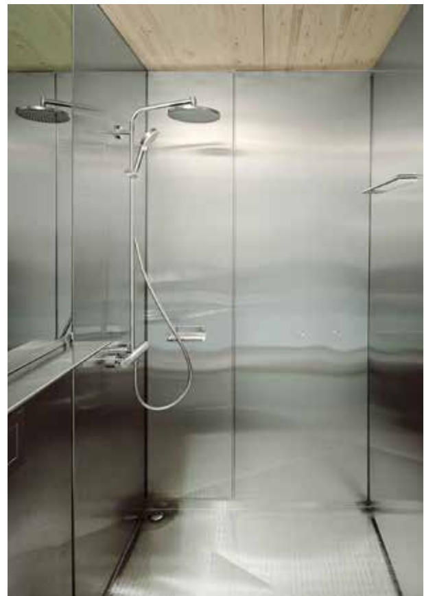
Die Bäder fertigte die Spenglerei aus eingehängten Chromstahlplatten. Selbst der Spiegel ist nicht aus Glas, sondern aus glatt geschliffenem Chromstahl.
